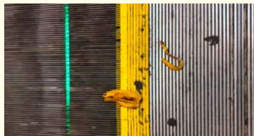
Escalator (Escada rolante), 2018
